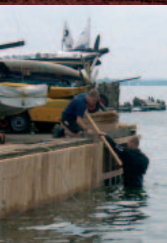
Am Dümmer baute die Düvel GmbH eine Pier- und Slipanlage für den englischen Segel- und Jachtclub
